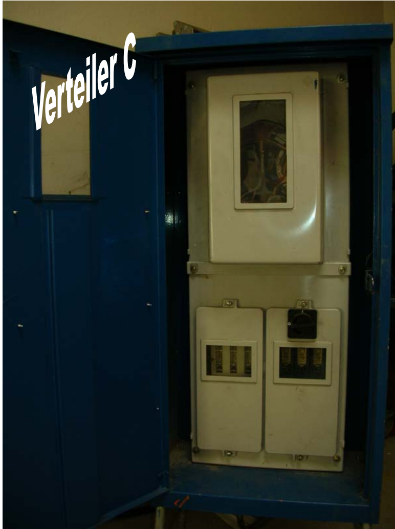
Anschlussverteiler für einen 63A Zähler mit 2 NH – Trennern des Typs NH-00
